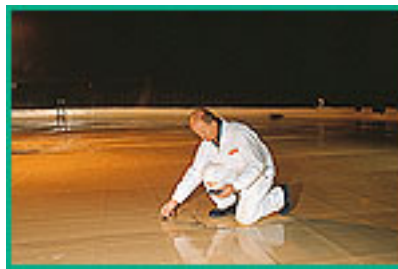
Vérification de l'étanchéité de la stratification au détecteur de porosité, et mesure d'épaisseur du revêtement.
